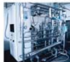
Станции CIP / SIP
